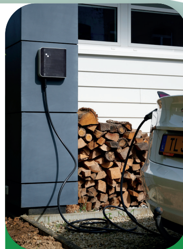
Exemple de borne incluse : Powerdale Nexxtender Home
